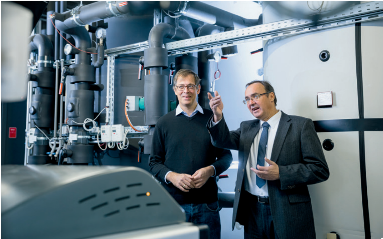
Besprechung in der Energiezentrale, die das Geothermiezentrum mit Erdwärme versorgt: Prof. Rolf Bracke (r.) und Gregor Busmann. © Sascha Kreklau/Fraunhofer
